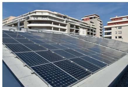
Panneaux photovoltaïques-école du Rouet ©Vdm
